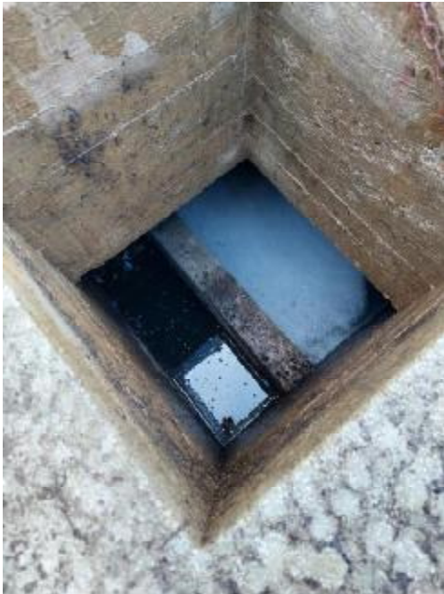
Kontrolno okno (pješčani filter)
